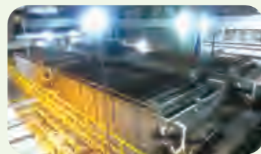
华润五丰上水屠房污水处理设施之次级气浮池
