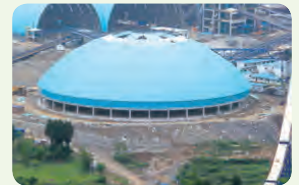
建设中的华润水泥(金沙)有限公司水泥熟料新型干法生产线
