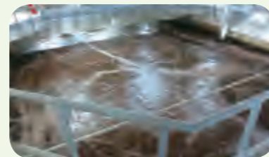
华润五丰上水屠房污水处理设施之好氧池
